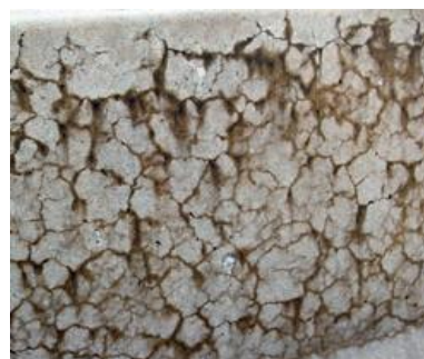
Figura 4 - Fendilhação em "craquelet" de muro em betão armado devido a reacção alcális-sílica [8]
