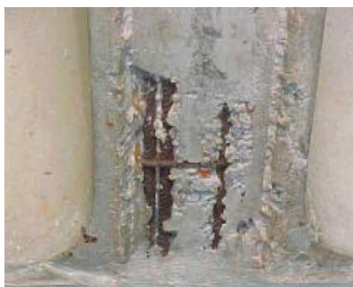
Figura 3 - Descasque de elemento em betão armado devido à corrosão das armaduras [6]
