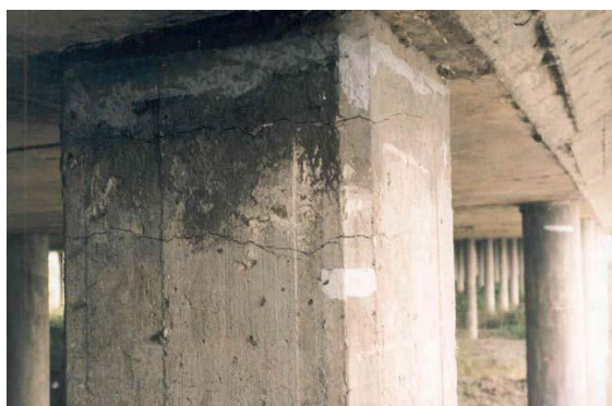
Figura 2 - Fendilhação de pilar de uma ponte devido a deformações excessivas impostas pelo tabuleiro [6]
