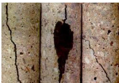
Figura 46 - Carotes cilíndricas extraídas de estrutura de betão fendilhada [6]
